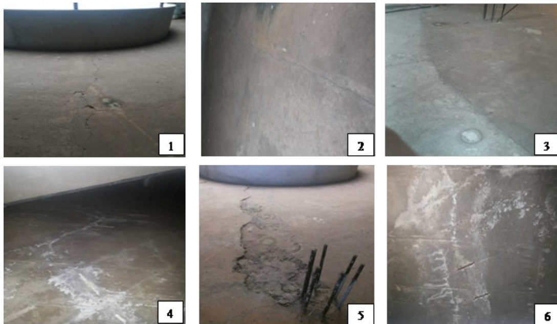
Figura 4. Diversas patologias presentes na laje. 1.Fissura, 2.Rachadura 3. Deterioração do Concreto e bitolas de aço aparente 4. Carbonatação do concreto 5-6. Corrosão da armadura
