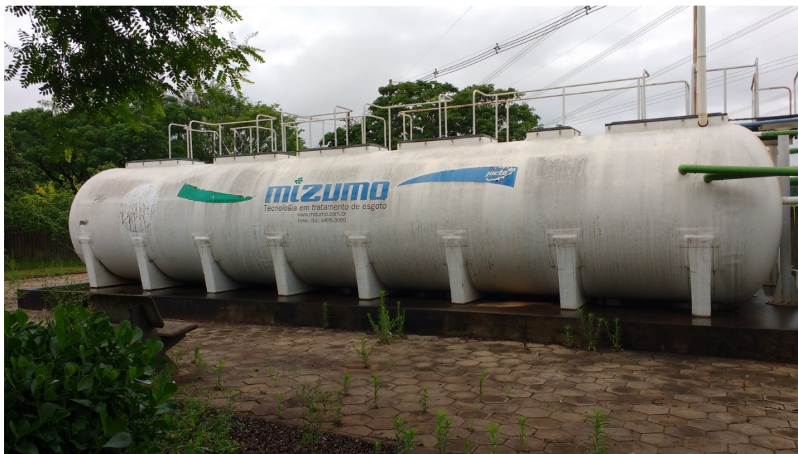
Figura 03 – Estação de Tratamento de esgoto
