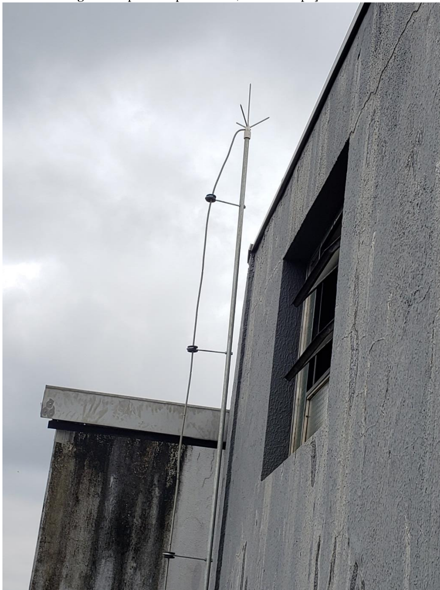
Imagem – Captor do tipo Franklin, mastro e espaçadores SPDA.
