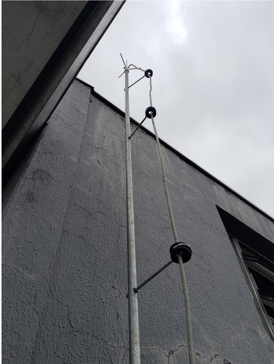
Imagem – Captor, mastro e espaçadores SPDA.
