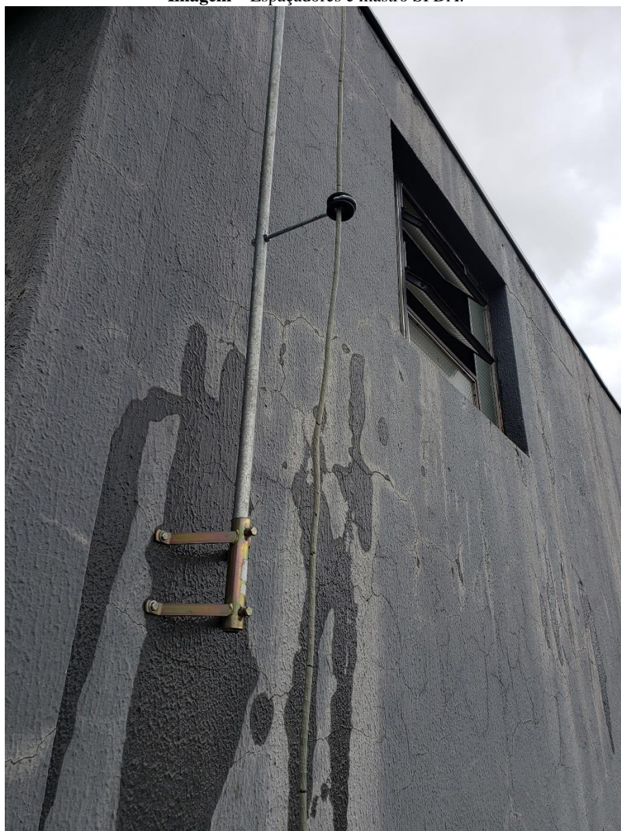
Imagem – Espaçadores e mastro SPDA.
