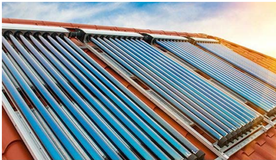
FIGURA 10 – Energia térmica para aquecimento de água residencial.
