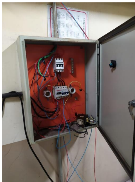
Figura 1. Quadro Elétrico. Fonte: Autores,2022.
