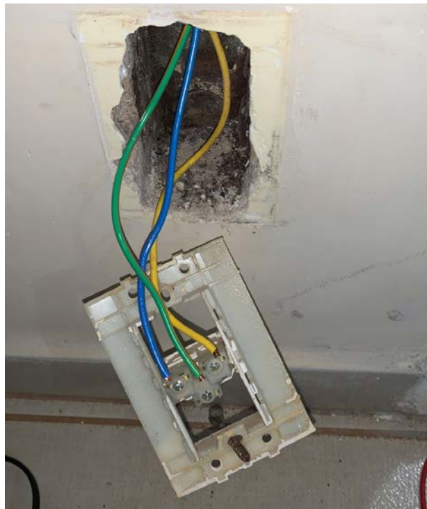
Figura 13- tomada com aterramento (fonte autor)
