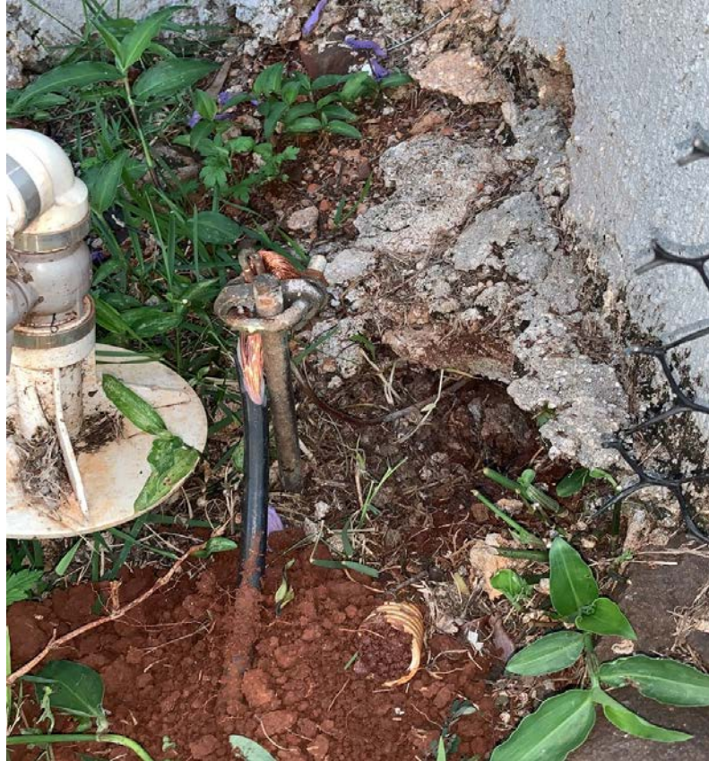
Figura 14- Haste de aterramento (fonte autor)
