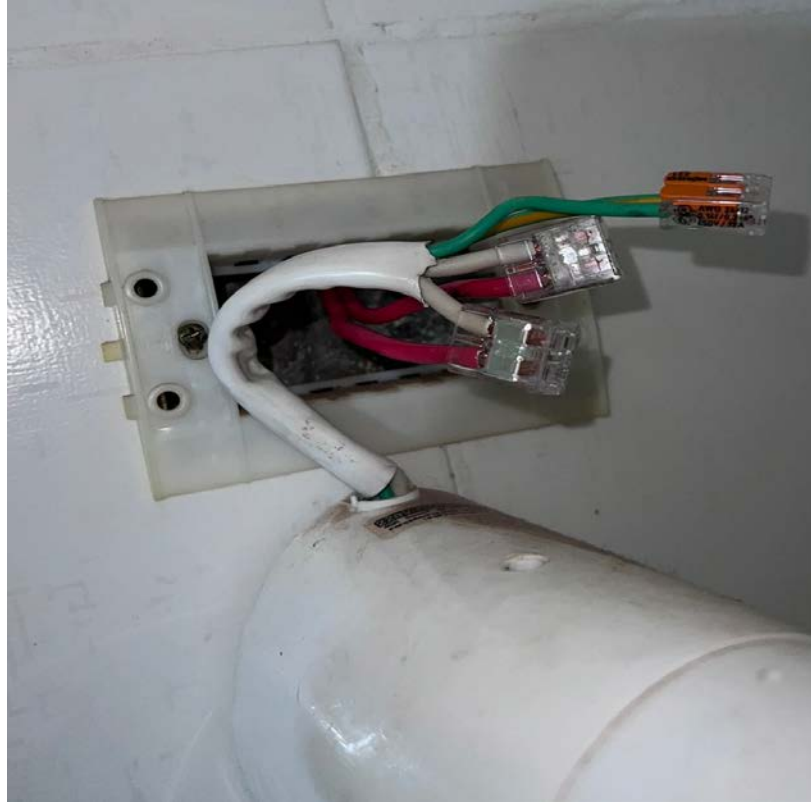
Figura 12- chuveiro com aterramento (fonte autor)
